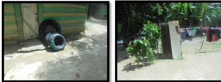
Gambar 3.5 Kondisi Fasilitas Pendukung Toilet Di Kawasan Objek Wisata
